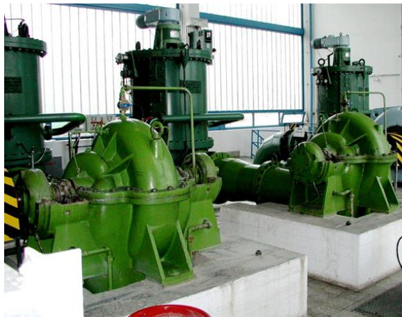
5. ábra Ipari hűtővíz szivattyútelep
