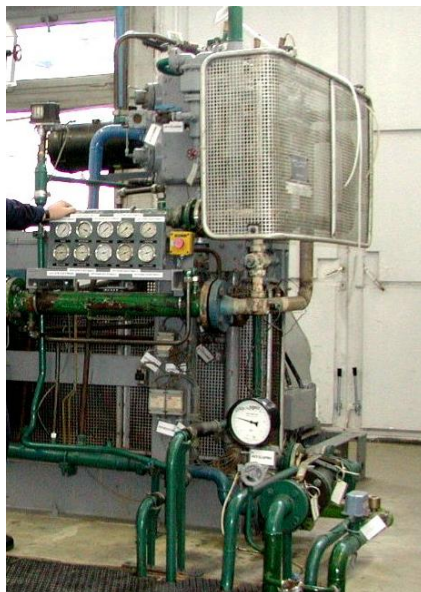
2. ábra Rekonstrukció előtti kompresszor
