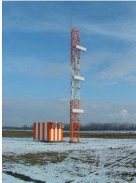
3. ábra. Siklopályaszög adó antenna és a hozzá tartozó konténer
