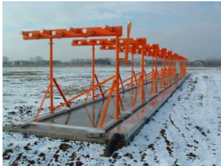
2. ábra. ILS berendezés irányszögadó antennasora vasbeton lemezalapon
